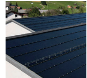
Steildach / PV-Anlage Photovoltaik-Indachanlage mit Blindmodul
