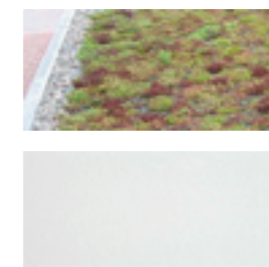
Flachdach Extensive Begrünung bzw. intensive Begrünung Dachrand Spenglerbleche, Balkon- und Dach-Randabschluss, Farbton PREFA, weiss
